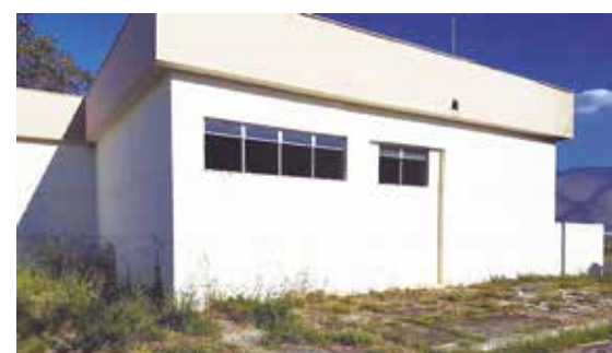
Mato alto e vidros quebrados
