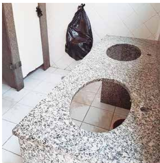
Banheiro masculino do IML sem pia e sem água
