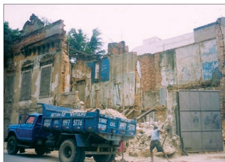
Em 2003, o imóvel estava em ruínas
