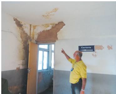
Investigador Alvaro mostra o péssimo estado da DP de Angra
