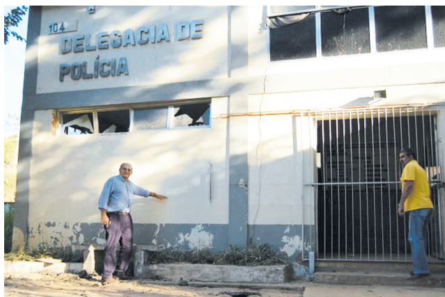
A 104ª DP interditada. Bandeira mostra a altura que a água chegou
