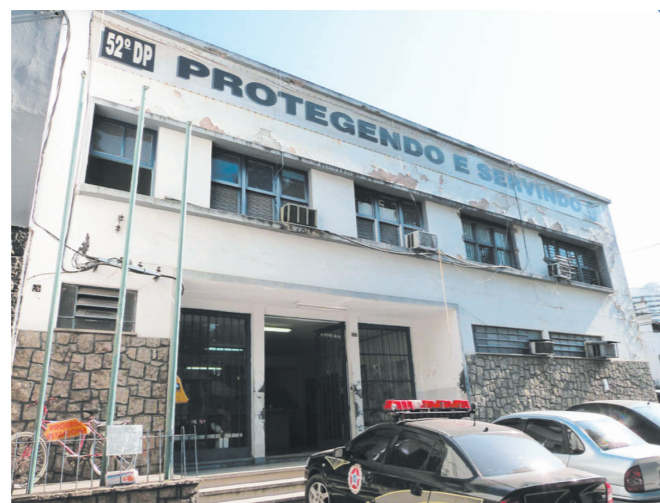
Falta conservação na 52ª DP
