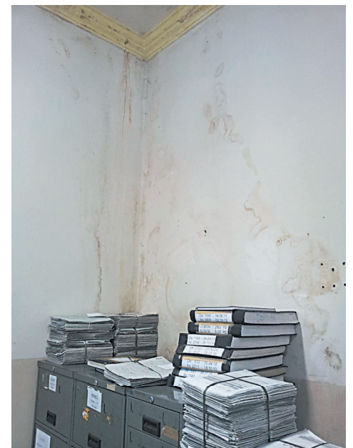
Processos da 74ª DP se acumulam em meio à infiltrações
