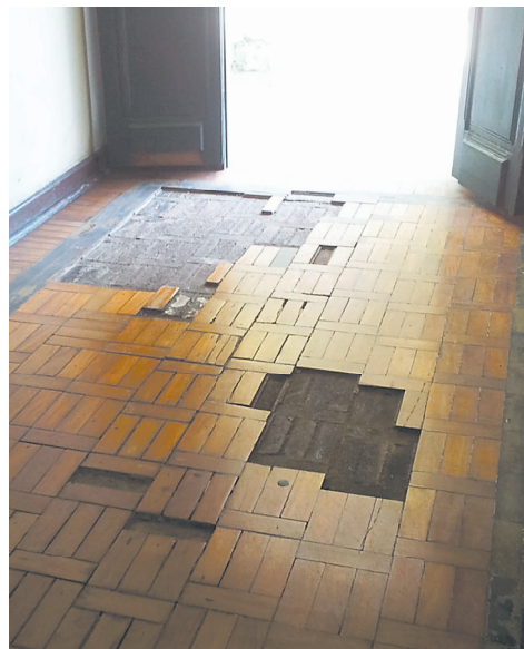
Piso solto na 74ª DP de Alcântara
